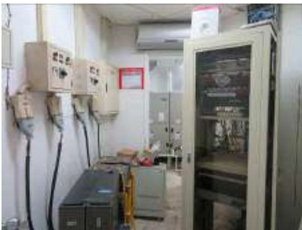
Vista Cuarto Eléctrico
